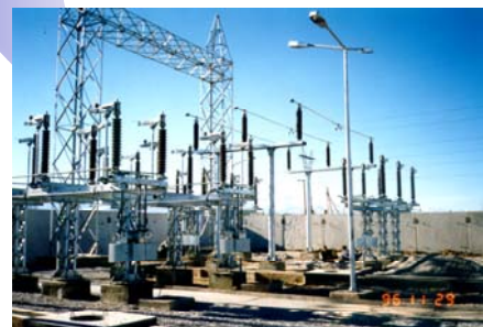
Sous-stations jusqu'à 400 kV
